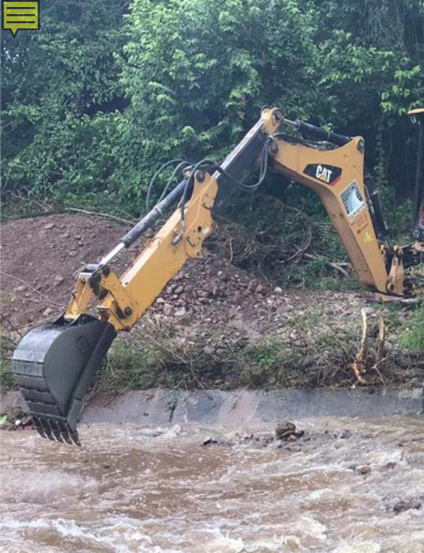
Deslave y azolvamiento potabilizadora Miravalles (agosto 2021)
